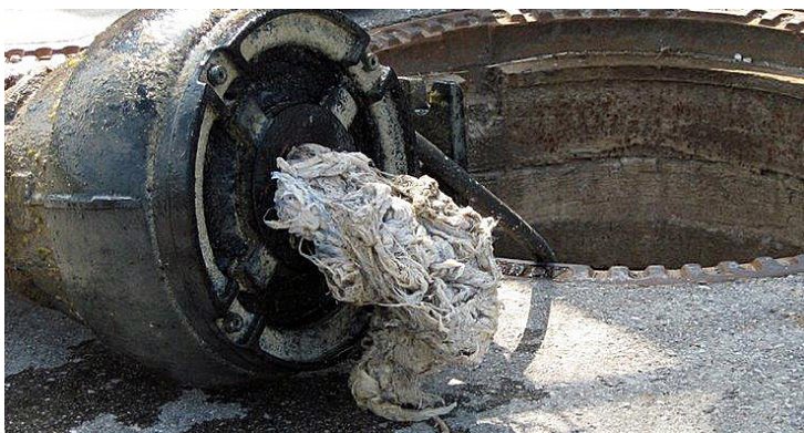
Grosses Problem: Von Müll verstopfte Abwasserpumpen müssen manuell gereinigt werden. (Foto zvg)
