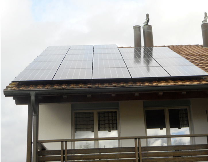
Die Photovoltaikanlage leistet bei Vollbetrieb 7,6 KWp. (Fotos zvg)
